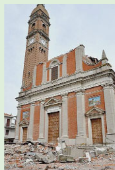
Accanto, la facciata della chiesa di Mirabello distrutta dal terremoto del 2012
