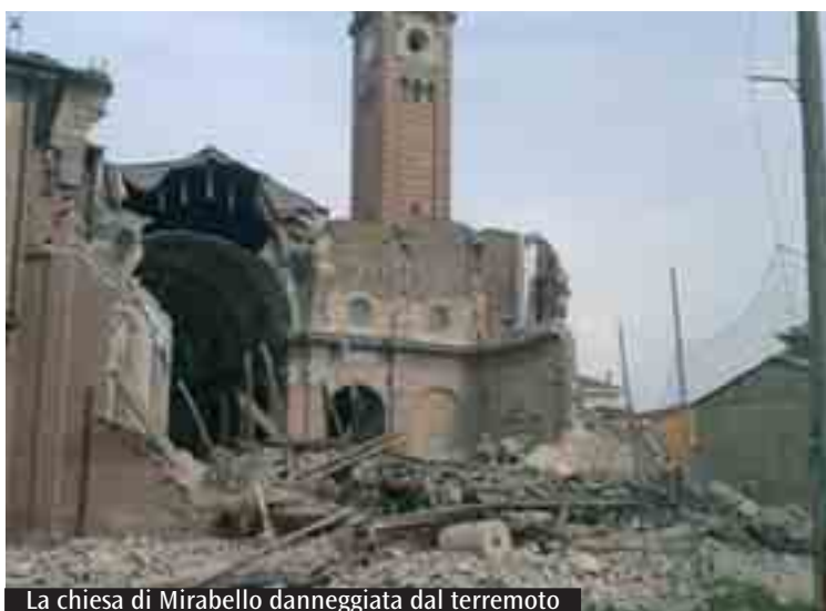
La chiesa di Mirabello danneggiata dal terremoto
