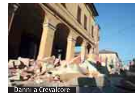
Danni a Crevalcore
